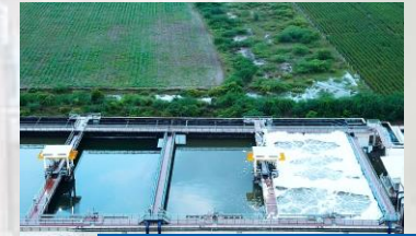
32.3 MLD STP, Surendranagar
