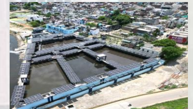
42 MLD STP, Bareilly
