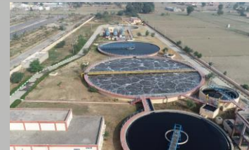
10.5 MLD STP, Fardabad
